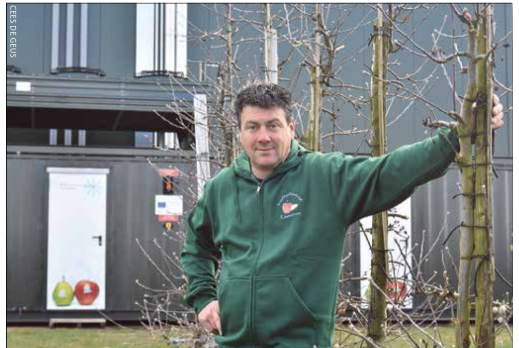
Hans van der Wind is tevreden over de nieuwe koelinstallatie, die gebruikmaakt van de combinatie propaan/CO 2 . 'Koeltechnisch ziet het er heel goed uit.'
