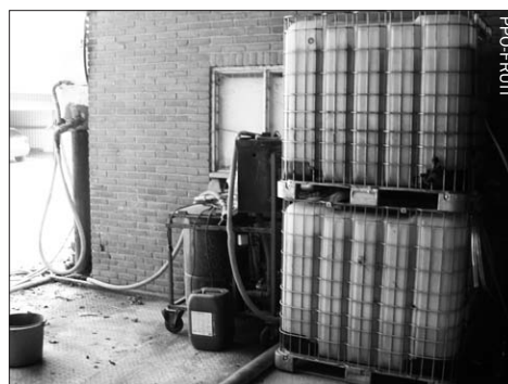
Prototype van een praktische vul- en spoelplaats met biofilter, die gebruikt kan worden in een bestaande bedrijfsvoering.
